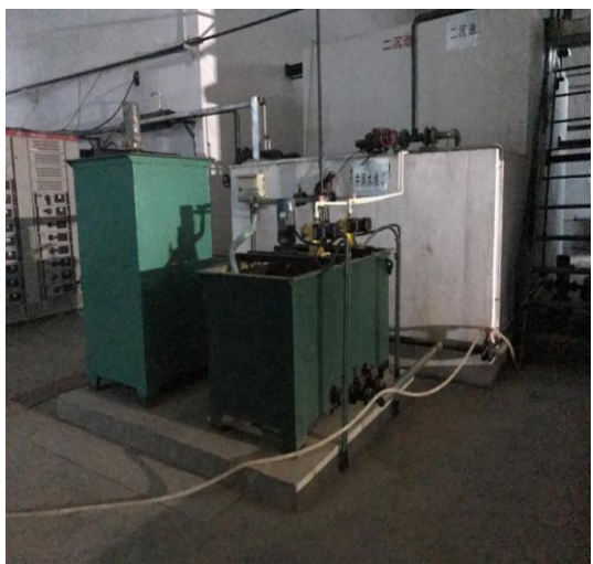
130t/d 污水处理站中间水间
