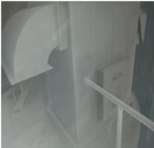
一期石灰仓顶除尘器
