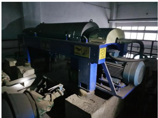
渗滤液处理站污泥沉降离心机
