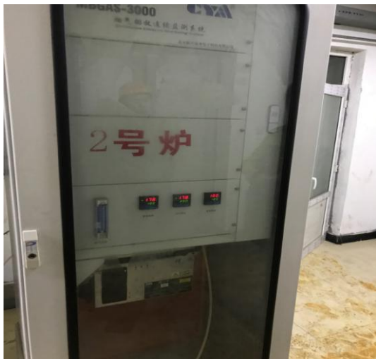
2#600t/d 炉排炉在线设备
