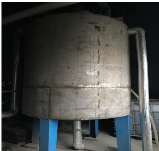
飞灰固化间螯合剂罐
