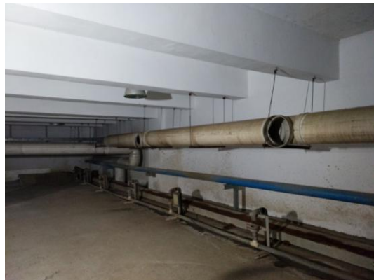
渗滤液处理站集气管道
