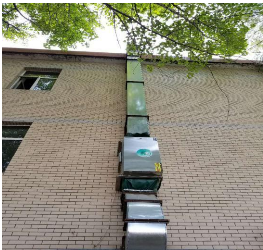
油烟排烟管道及油烟净化器
