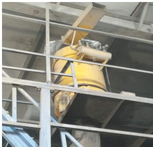
一期飞灰固化搅拌机布袋除尘器
