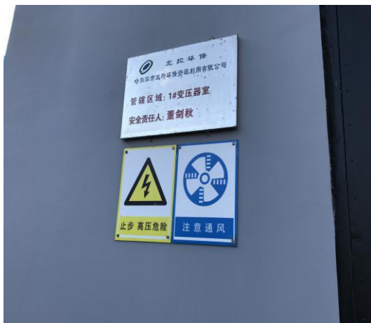
升压站 1#变压器室
