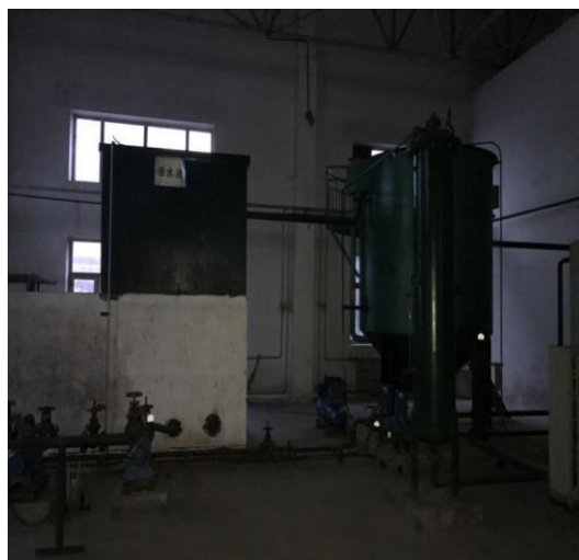
130t/d 污水处理站清水池
