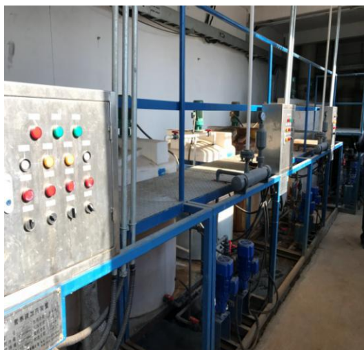
渗滤液预处理间加药装置
