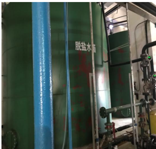
化学水处理部分脱盐水箱
