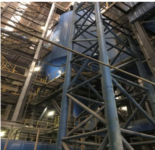
3#600t/d 炉排炉脱酸塔
