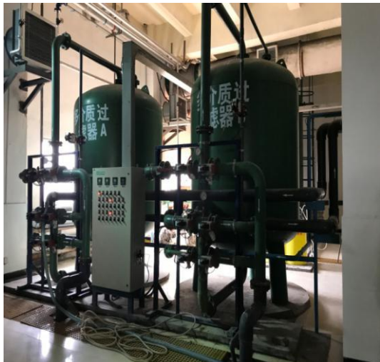
化学水处理部分多介质过滤器
