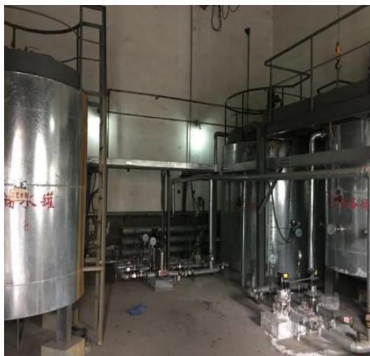
一期循环流化床焚烧炉脱硝系统
