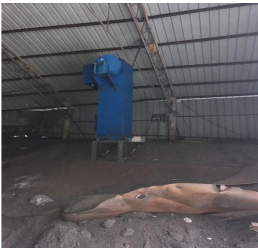
煤仓布袋除尘器
