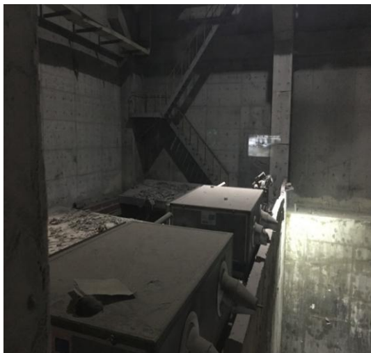
垃圾抓斗检修孔
