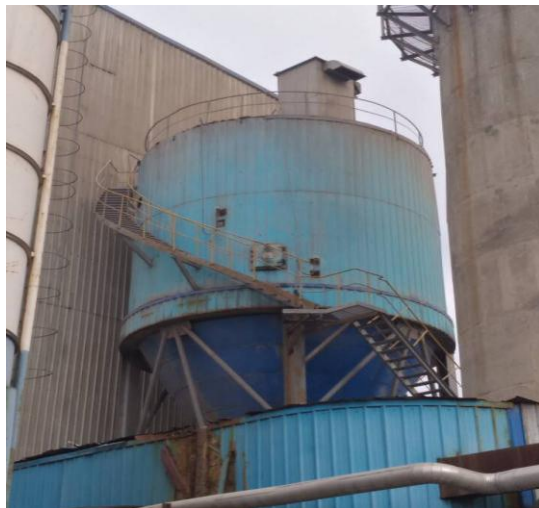
一期飞灰仓除尘器
