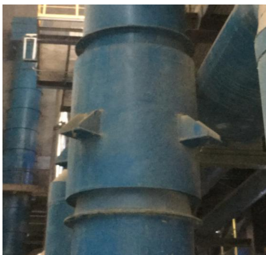
2#炉排炉 2 次风消音器
