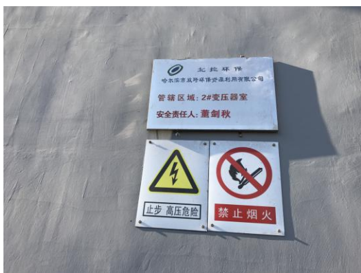
升压站 2#变压器室
