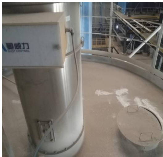
二期石灰仓顶除尘器
