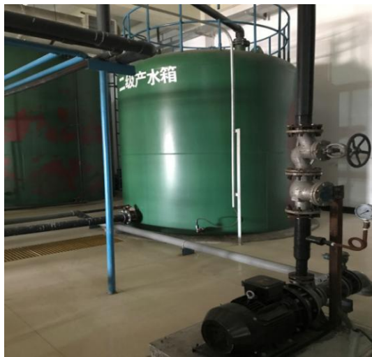
化学水处理部分二级水箱
