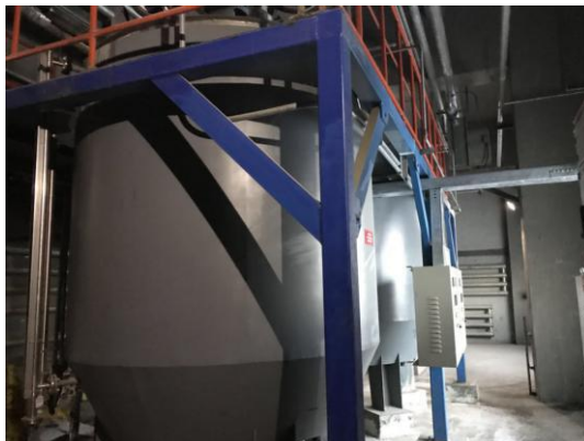
尿素溶解罐及储存罐
