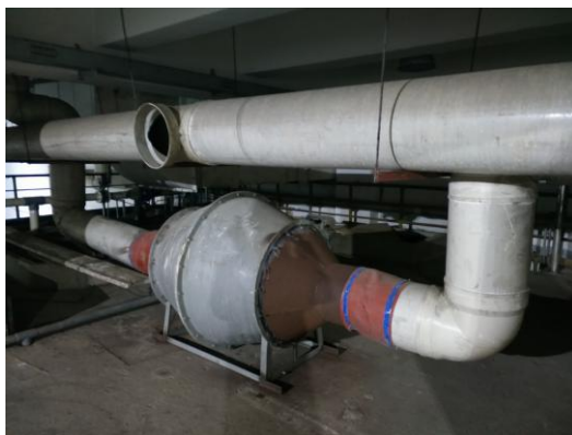
渗滤液处理站集气管道
