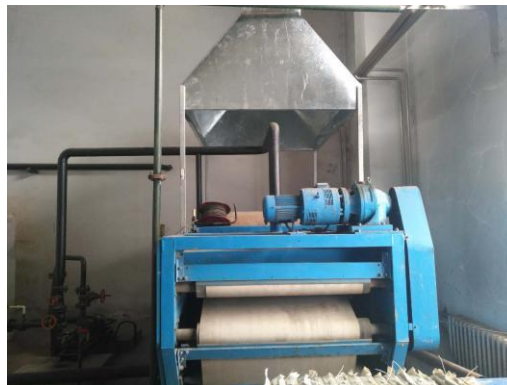
130t/d 污水处理站污泥脱水机集气罩
