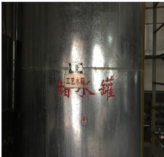
脱硝装置储水罐
