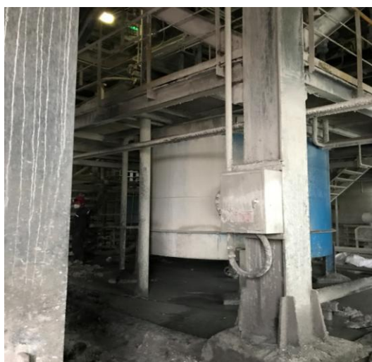
二期石灰浆罐
