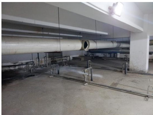
渗滤液处理站集气管道
