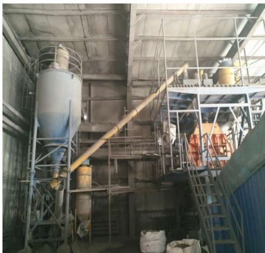
一期飞灰固化间内部
