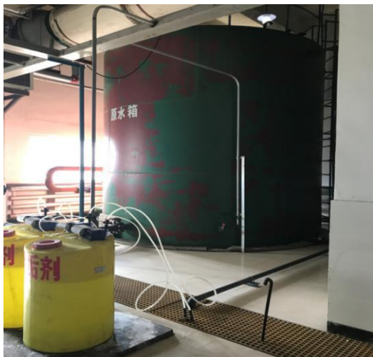
化学水处理部分原水箱
