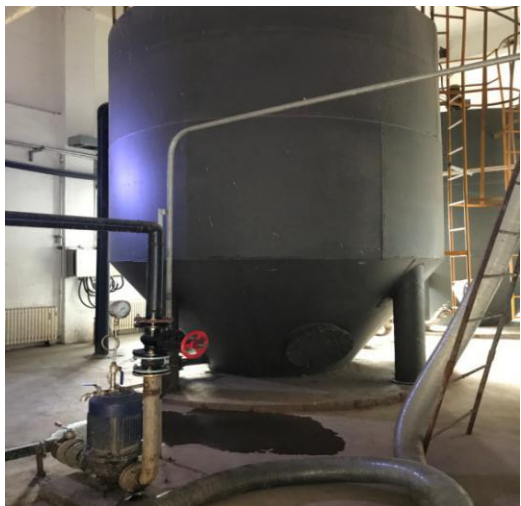
渗滤液预处理罐
