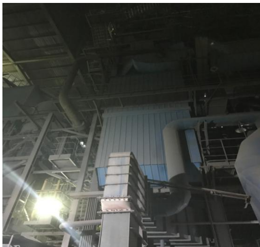
一期循环流化床焚烧炉余热锅炉
