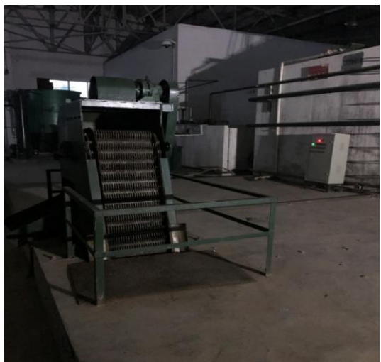
130t/d 污水处理站格栅
