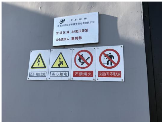
升压站 3#变压器室
