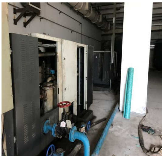
二期空压机设备
