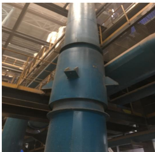
3#炉排炉 2 次风消音器
