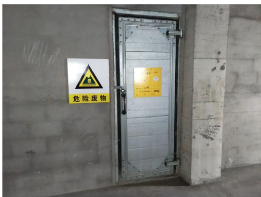
危险废物暂存间（废矿物油暂存间）
