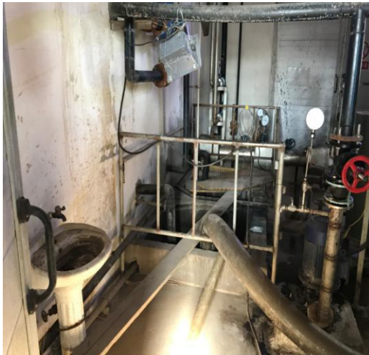
渗滤液预处理间调节池
