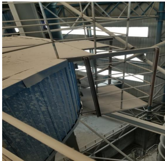
3#600t/d 炉排炉脱硫前采样孔
