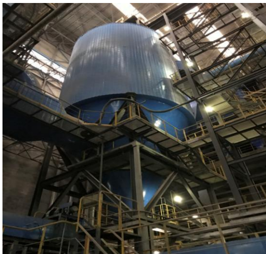
2#600t/d 炉排炉脱酸塔
