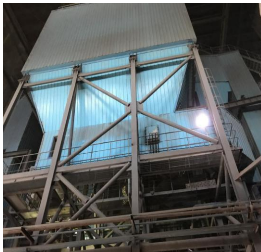
一期布袋除尘器
