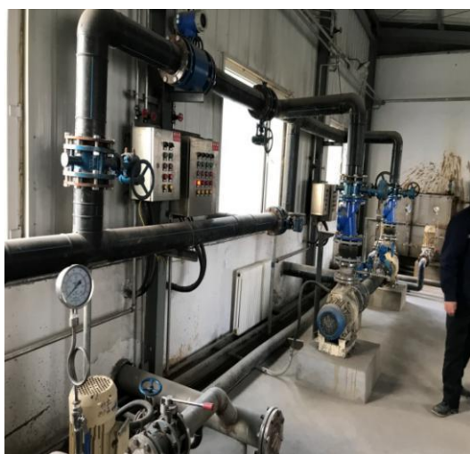
渗滤液处理站分流泵
