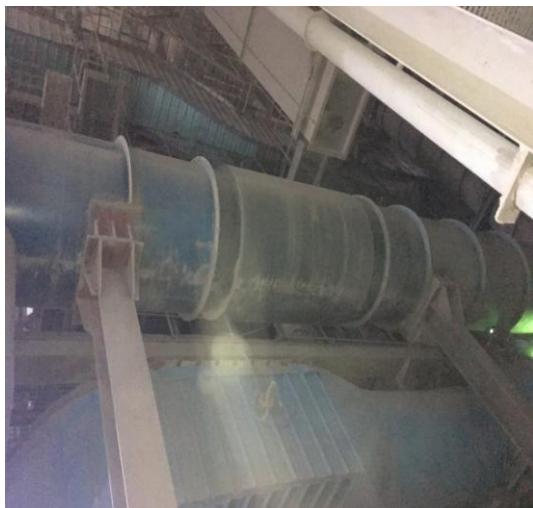
300t/d 循环流化床焚烧炉 1 次风机消音器
