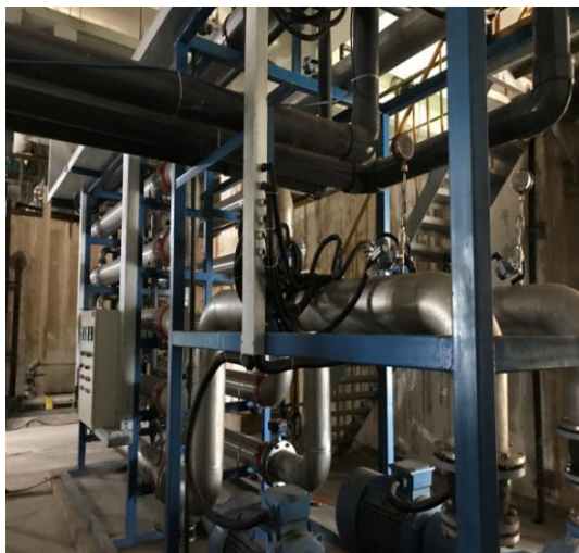
渗滤液处理超滤
