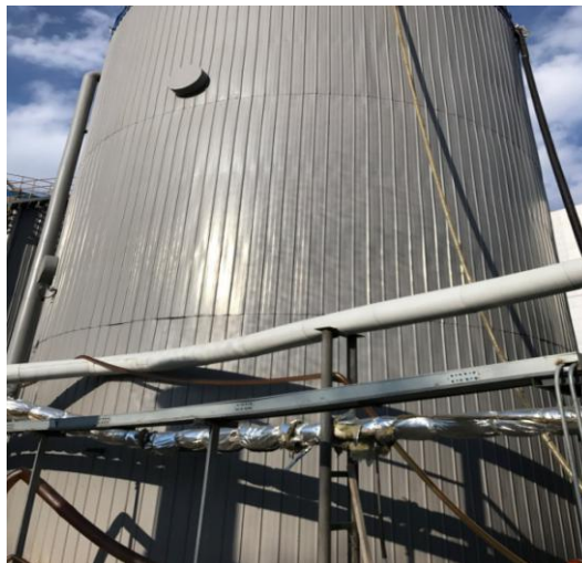
渗滤液处理部分厌氧罐
