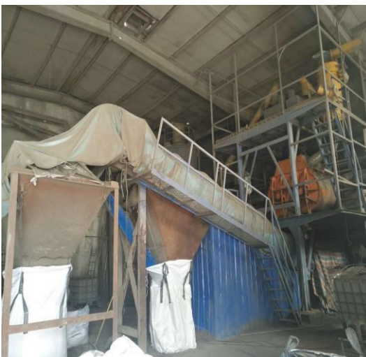
一期固化间内搅拌主机及输送皮带
