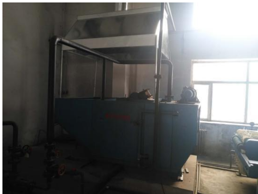
130t/d 污水处理站污泥脱水机
